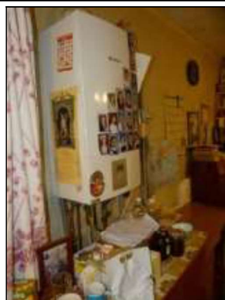
Ēkas pirmais stāvs(gāzes apkures katls)
